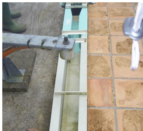
Figure 2.8 - Canal venturi en sortie de STEU
